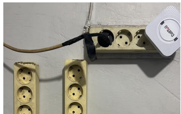
Gambar 4 Pemasangan alat penerima tanda emergency bell di pos tengah
